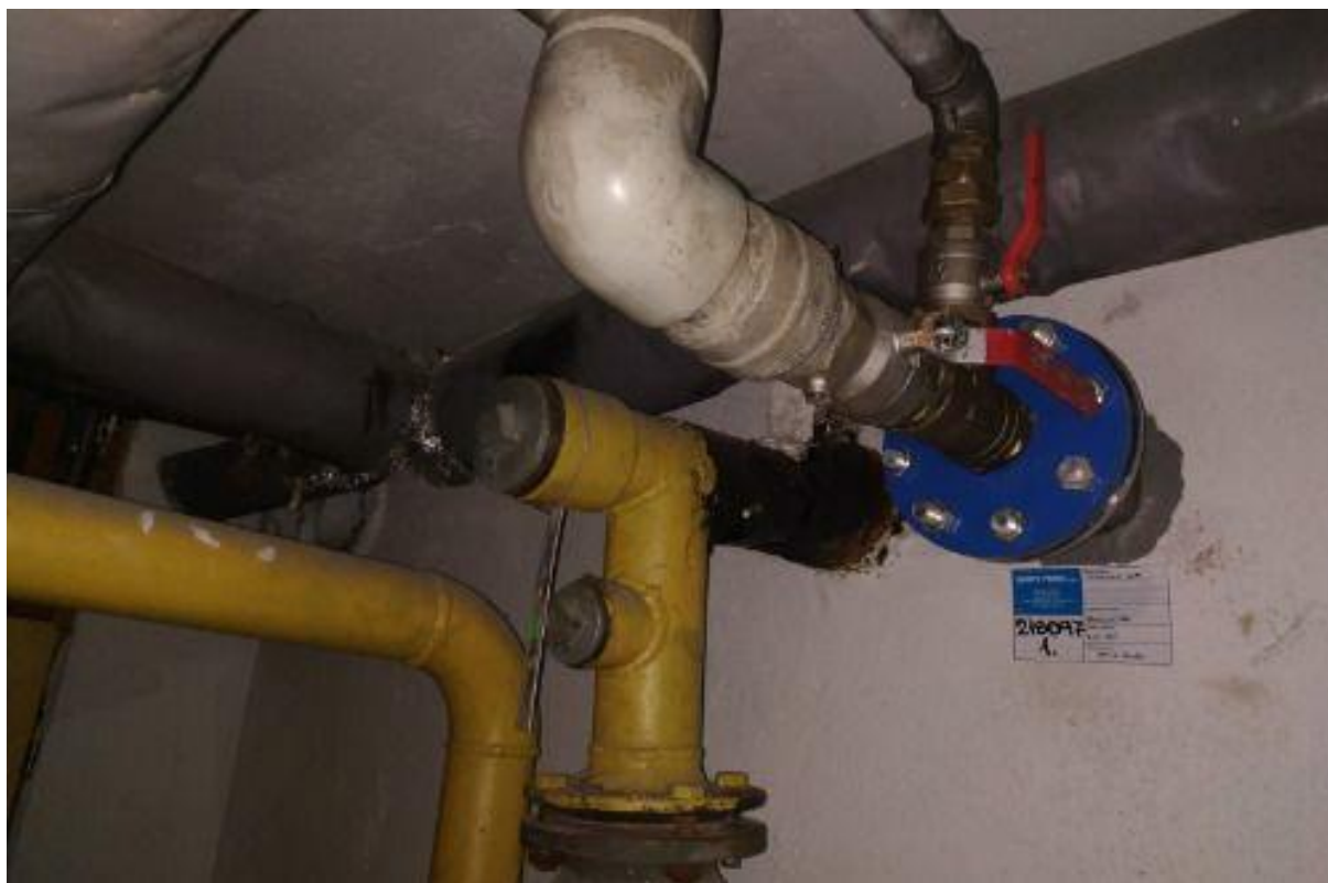
Obrázek 3: Snímek rozvodů v suterénu objektu Palermská
